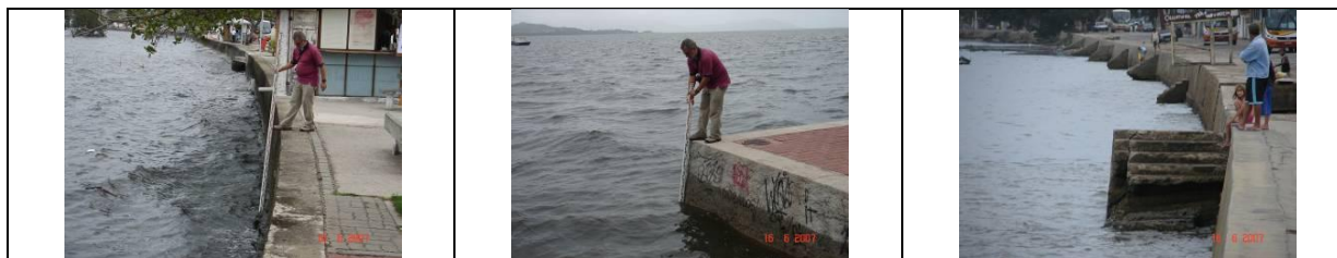
Figura 64: Praias de Dona Luíza, do Cardo e de Sepetiba: presença de muros refletores. Observar a destruição da escada de acesso à praia. (Fotos: Claudio Neves, 2007).
