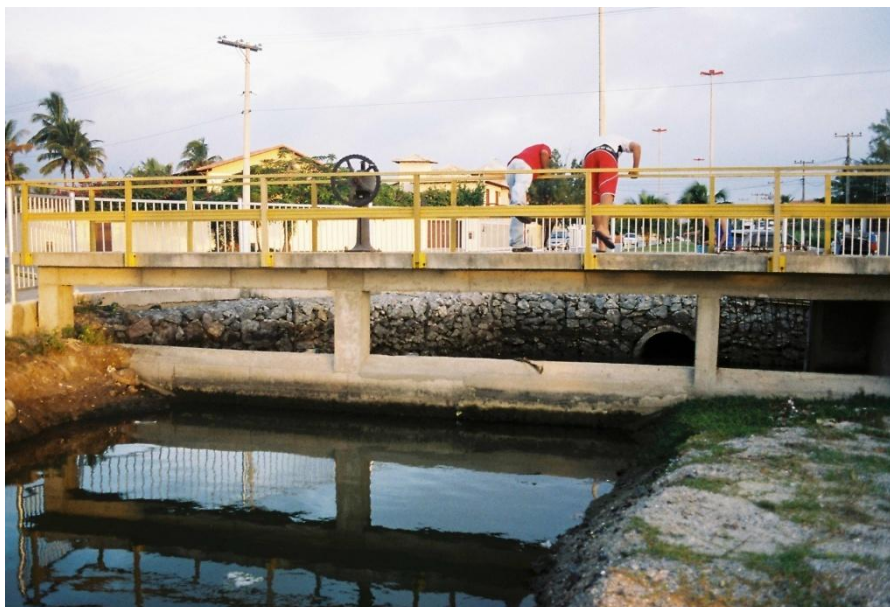
Figura 57: Sistema de comportas nos canais de captação de esgotos e águas pluviais em Cabo Frio. (Foto: C.F. neves, 2007).
